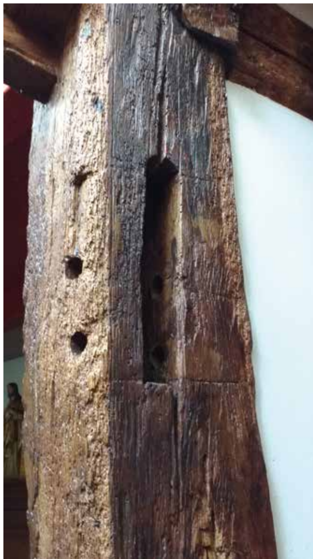
Een pengat, waar de pen van een (verwijderde) dwarsbalk in past. De kraslijnen aan boven en onderkant voor het aftekenen van het pengat zijn nog aanwezig. Ook te zien zijn twee gaatjes dwars door de verbinding, waarin houten toognagels werden geslagen om de verbinding te fixeren.
