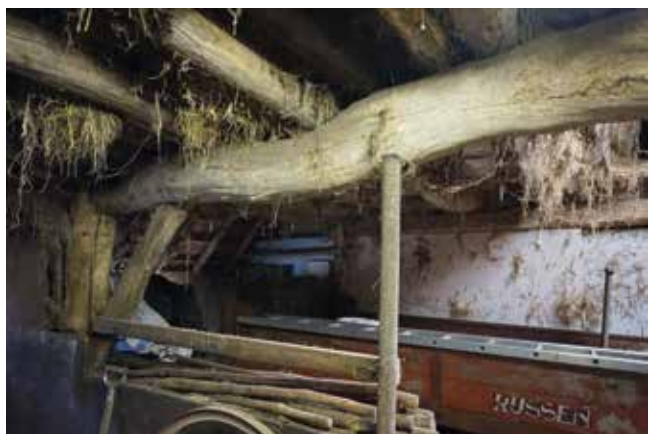
Deze ankerbalk is alleen geblekt en niet gekantrecht.
